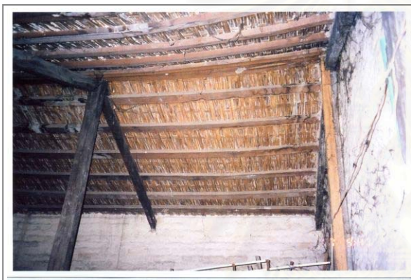
ภาพที่ 44. วัสดุไม้ไผ่สานรองรับหลังคาตึกดิน
