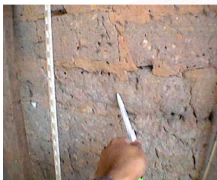
ความเสียหายที่เกิดจาก ความชื้นขึ้นจากพื้นดินเข้าสู่ อาคาร
