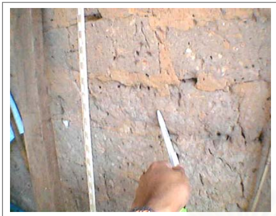
ภาพที่ 87. การก่อแนวผนังอิฐดินดิบที่สังเกตเห็น ได้เนื่องจากปูนฉาบได้หลุดร่อนออกไป ที่มา : จากการสำรวจ
