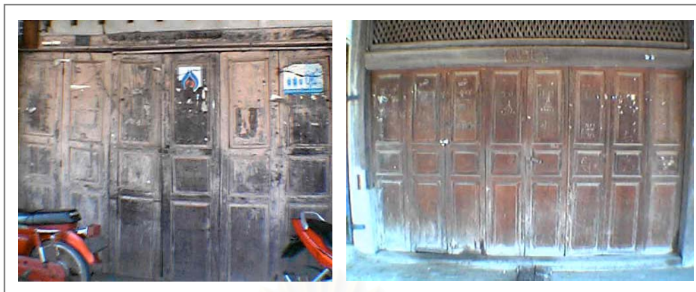
ภาพที่ 141. สภาพประตูด้านหน้าอาคารซึ่งเนื้อไม้ถูกแดด-ฝน มาเป็นเวลานาน จึงเกิดรอยกร่อนที่ผิวหน้าของตัวบาน ที่มา : จากการสำรวจ
