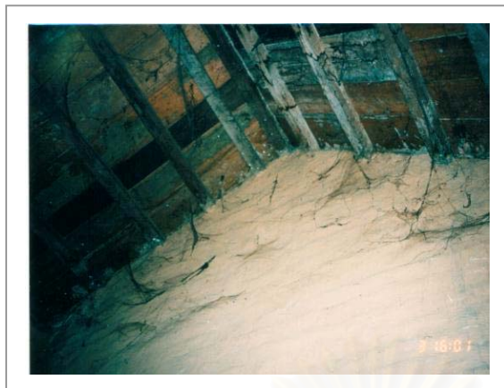
ภาพที่ 62. สภาพหลังคาเมื่อมองจากภายใน ที่มา : จากการสำรวจ
