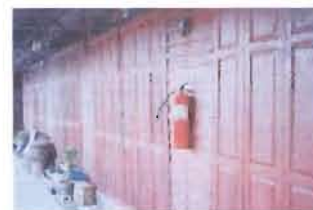
ถังดับเพลิงไม่เพียงพอ ไม่สามารถแก้ปัญหาได้ เวลาเกิดเพลิงไหม้จริง การติดตั้งไม่เหมาะสม
