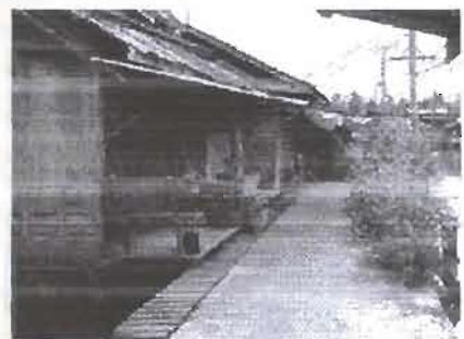
ทางเดินคอนกรีตเสริมเหล็กมีส่วนไม่ปิด
