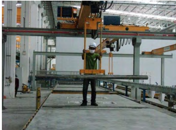
ภาพที่ 3.21 คนงานกำลังถอดแบบเหล็กข้าง ที่มา: จากการสำรวจ
