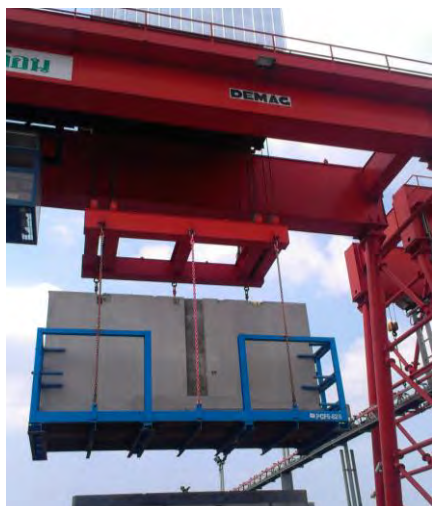
ภาพที่ 3.26 เครนขณะยกตะกร้าเหล็ก ที่มา: จากการสำรวจ
