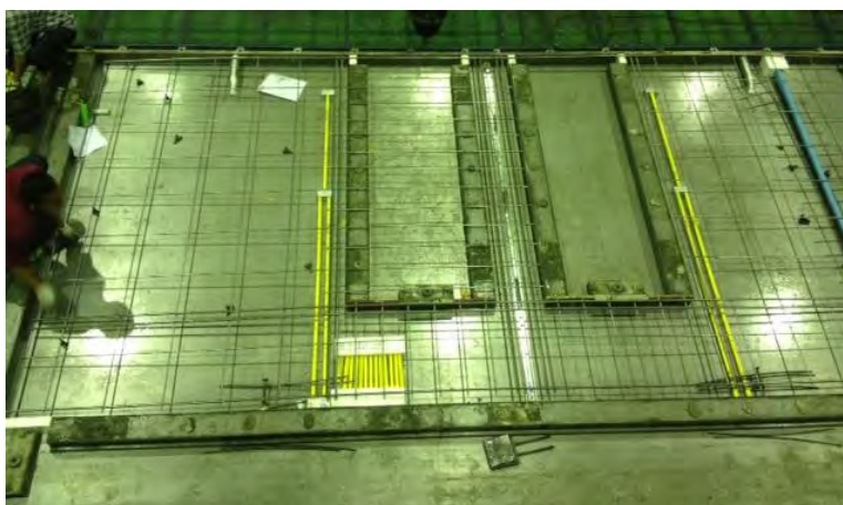
ภาพที่ 5.9 เหล็กตะแกรงเสริมที่เกินออกมาในช่องเปิดประตู
