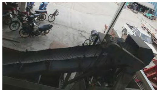
ภาพที่ 3.6 สายพานลำเลียงเศษคอนกรีต ที่มา: จากการสำรวจ
