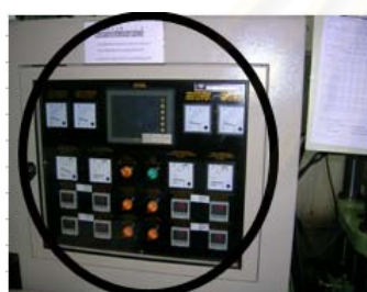
5. ตู้คอนโทรลและปุ่มฉุกเฉิน
