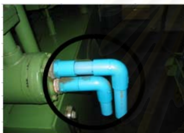
15. ระบบน้ำหล่อเย็น
