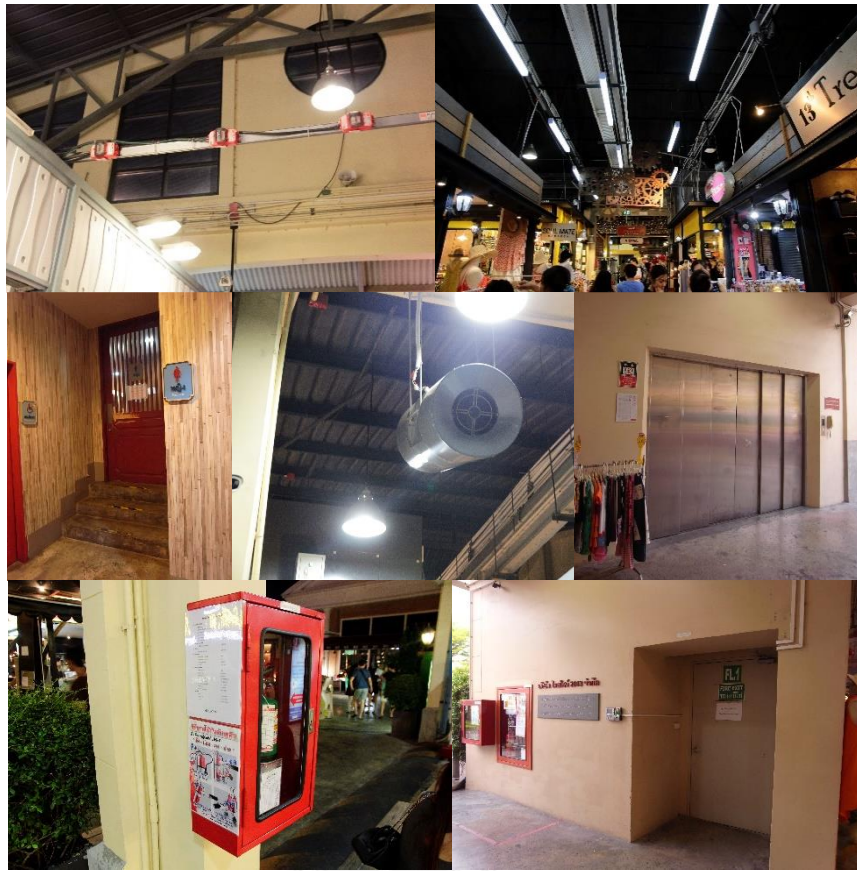
ภาพที่ 66 งานระบบอาคาร
