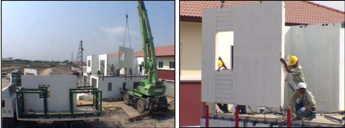
ภาพที่ 3. 21 การติดตั้งผนังสำเร็จรูปชั้นบน
