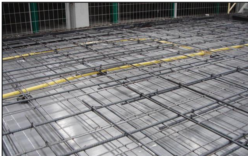
ภาพที่ 3. 8 การยกโครงเหล็กเสริมที่ทำการผูกเรียบร้อยแล้วติดตั้งลงบนโต๊ะหล่อ
