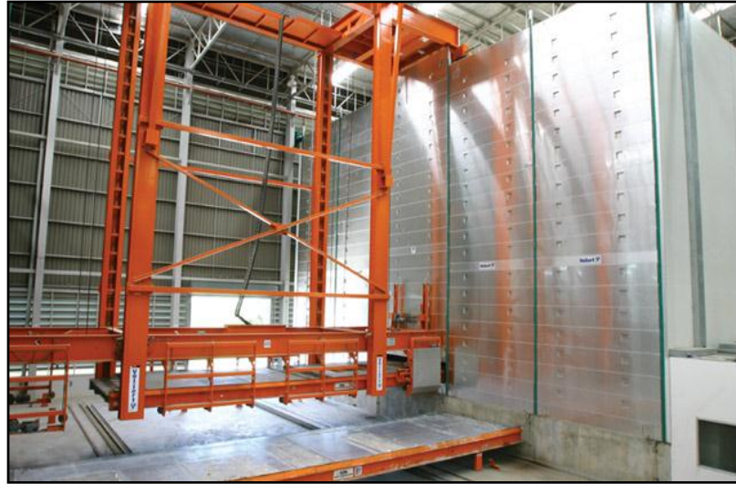
ภาพที่ 3. 12 ห้องบ่มคอนกรีต
