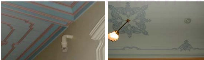
ภาพที่ 3-43 การติดตั้งอุปกรณ์ของระบบดับเพลิงภายในพิพิธภัณฑสถานแห่งชาติประเทศไทย ที่ทำการเปลี่ยนสีของอุปกรณ์ให้มีความกลมกลืนกับสีของผนังภายใน
