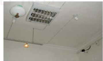
ภาพที่ 3-44 การติดตั้งอุปกรณ์ของระบบดับเพลิงภายในพิพิธภัณฑสถานสมเด็จพระปกเกล้าเจ้าอยู่หัว
