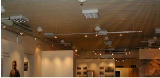
ภาพที่ 3-41 เครื่องปรับอากาศแบบแยกส่วนภายในพิพิธภัณฑสถานสมเด็จพระปกเกล้าเจ้าอยู่หัว
