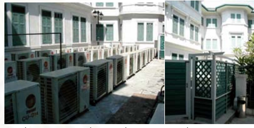
ภาพที่ 3-42 ที่วางเครื่องคอนเดนซึ่งยูนิตด้านหลังพิพิธภัณฑสถานสมเด็จพระปกเกล้าเจ้าอยู่หัว
