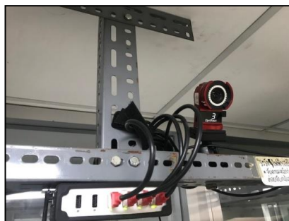
ภาพที่ 3. 23 กล้องอินฟราเรดที่ติดตั้งเรียบร้อยแล้ว
