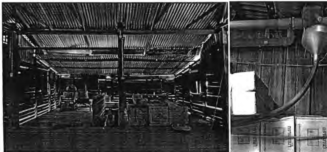
สภาพพื้นที่ชั้นบนของเรือนแถวที่ถูกทิ้งร้างและทรุดโทรม (ซ้าย) และปัญหาการระบายน้ำฝน (ขวา)
