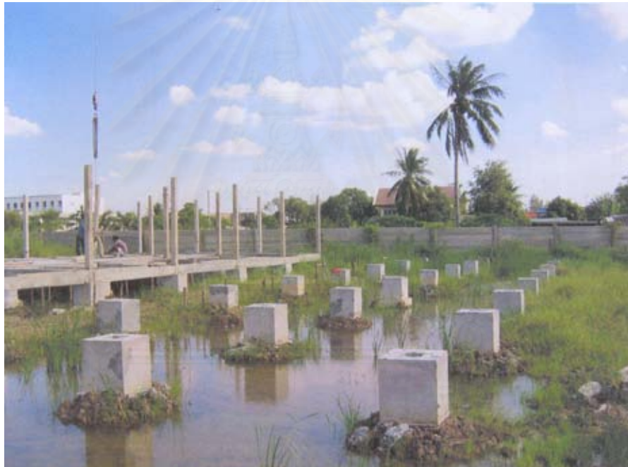
รูปที่ 5-1 แสดงการจัดเตรียมฐานรากเพื่อรองรับระบบเสาและคานสำเร็จรูป
