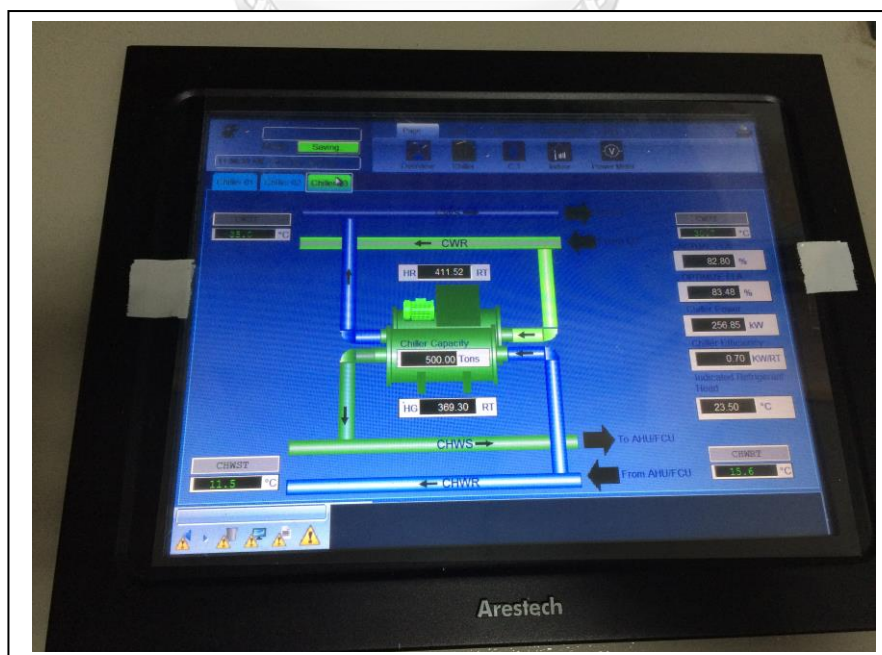
รูปที่ 3.7 คอมพิวเตอร์สำหรับระบบควบคุมแบบอัตโนมัติ
