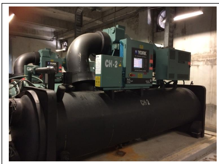
รูปที่ 3.1 เครื่องทำน้ำเย็นแบบระบายความร้อนด้วยน้ำ เครื่องสูบน้ำเย็น ขนาด 45 กิโลวัตต์ จำนวน 3 ชุด ดังแสดงในรูปที่ 3.2
