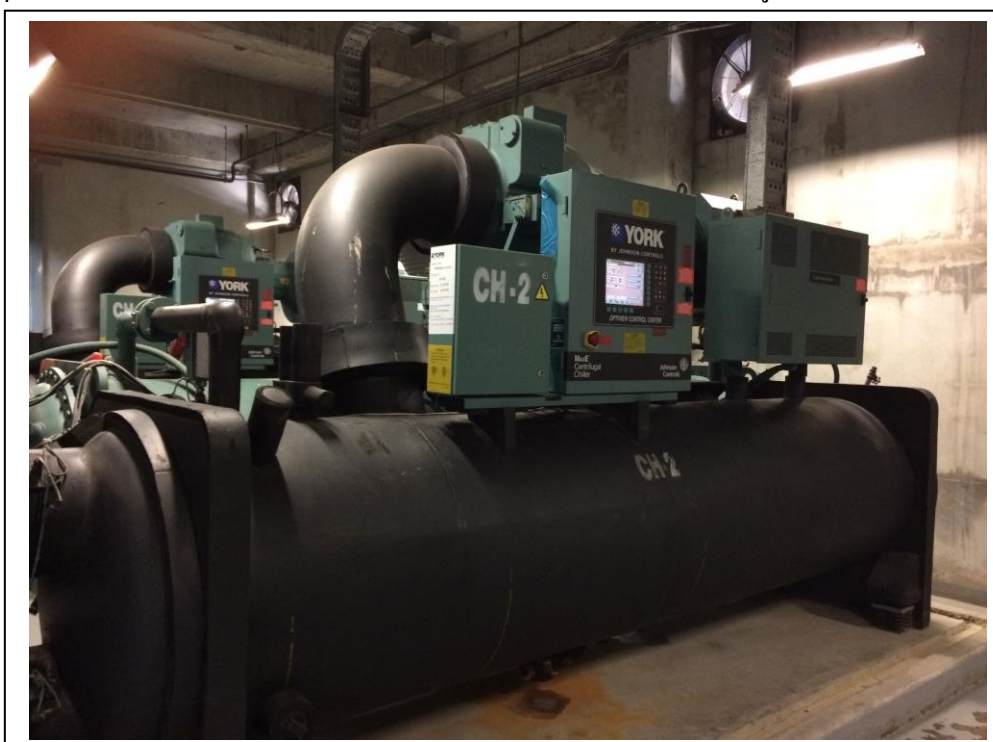
รูปที่ 1.1 เครื่องทำน้ำเย็นของระบบปรับอากาศแบบรวมศูนย์ภายในห้างสรรพสินค้า
