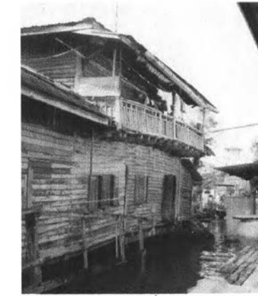
สิ่งก่อสร้างต่อเติมด้านหลัง สภาพทรุดโทรม
