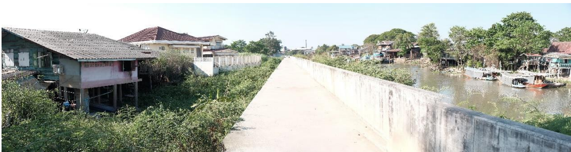
ภาพที่ 4-13 ภาพโครงสร้างทางเดินและกำแพงป้องกันน้ำท่วมบริเวณแม่น้ำน้อย ถ่ายเมื่อ 10 มีนาคม 2562
