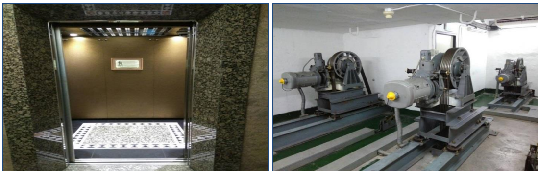
ภาพที่ 50 ตู้ลิฟต์โดยสารและห้องเครื่องลิฟท์อาคาร C
