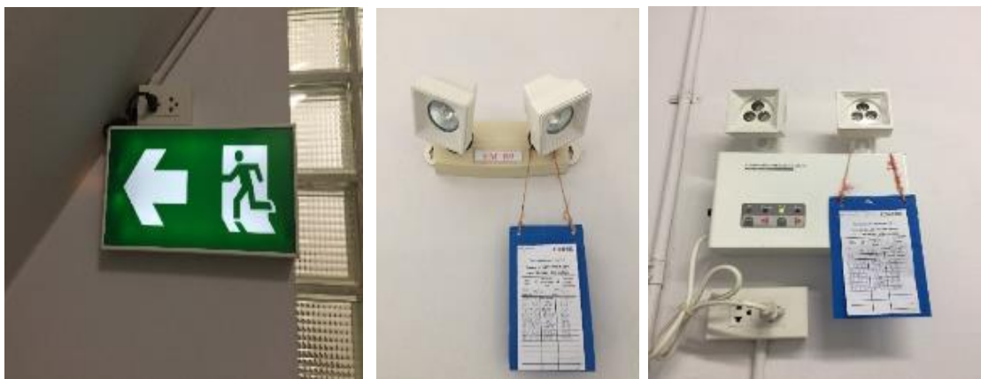
ภาพที่ 56 ป้ายทางหนีไฟและไฟส่องทางฉุกเฉินอาคาร C
