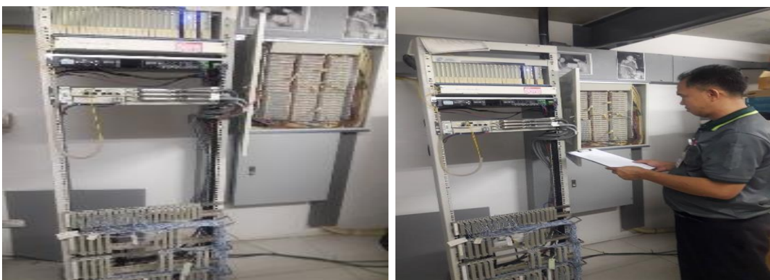
ภาพที่ 75 ระบบโทรศัพท์อาคาร D
