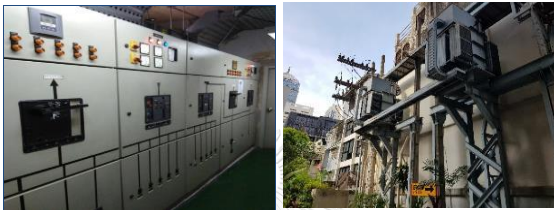
ภาพที่ 47 ระบบไฟฟ้าหลักและหม้อแปลงไฟฟ้าอาคาร C
