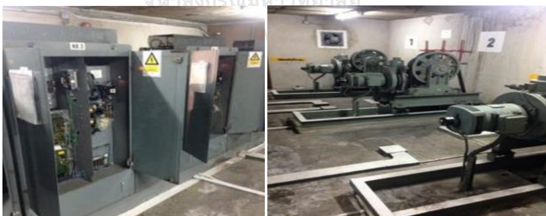
ภาพที่ 29 ห้องเครื่องลิฟท์อาคาร B
