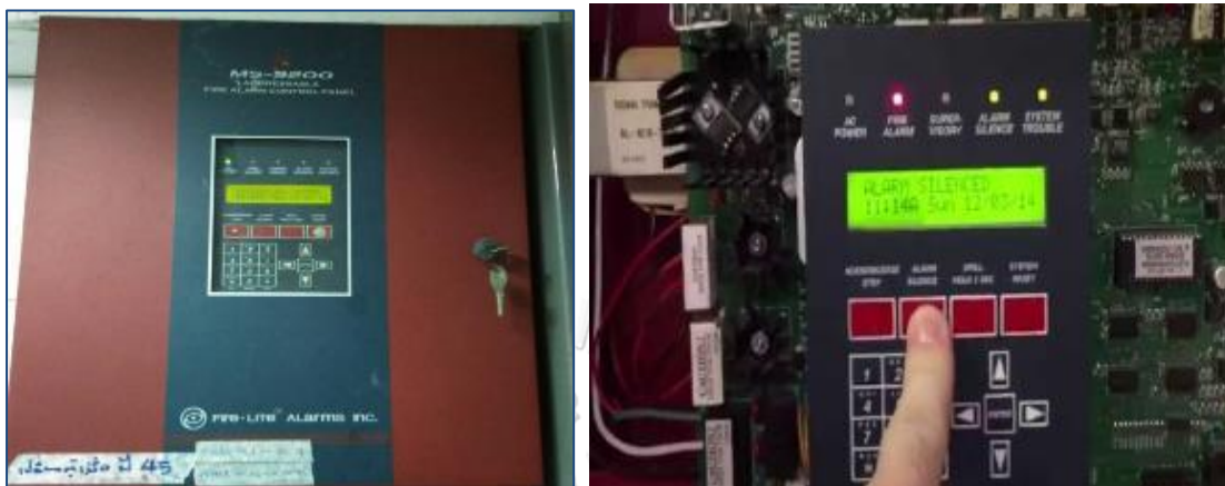
ภาพที่ 57 ตู้ควบคุมระบบแจ้งสัญญาณเหตุเพลิงไหม้อาคาร C
