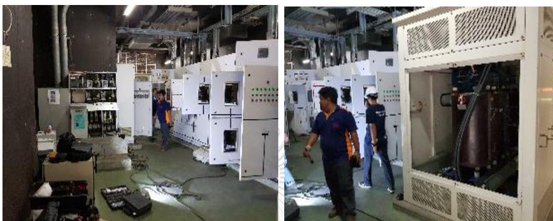
ภาพที่ 68 ระบบไฟฟ้าหลักและหม้อแปลงไฟฟ้าอาคาร D
