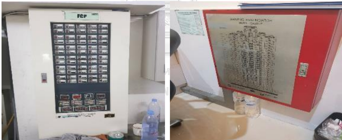
ภาพที่ 15 ตู้ควบคุมและแจ้งสัญญาณเหตุเพลิงไหม้อาคาร A
