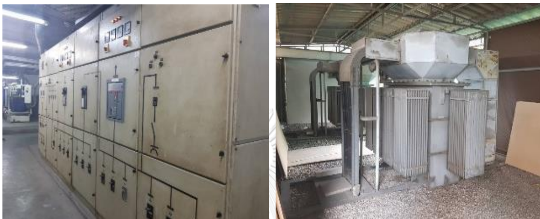
ภาพที่ 4 ระบบไฟฟ้าหลักและหม้อแปลงไฟฟ้าอาคาร A
