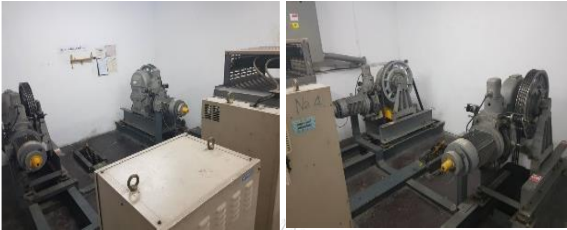
ภาพที่ 8 ห้องเครื่องลิฟท์อาคาร A
