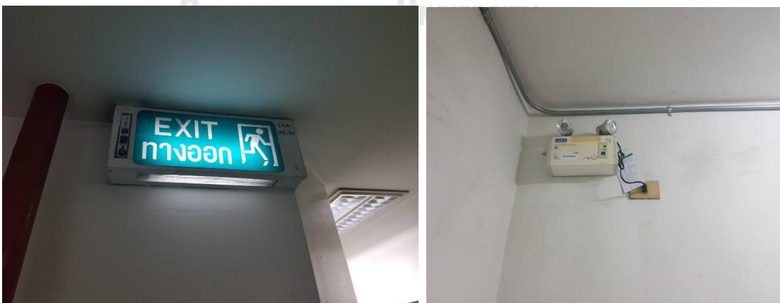
ภาพที่ 77 ป้ายทางหนีไฟและไฟส่องทางฉุกเฉินอาคาร D
