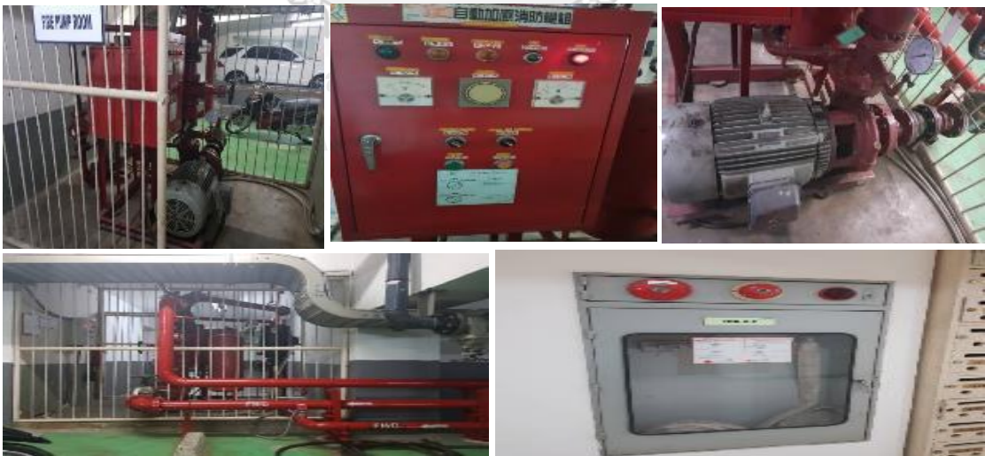
ภาพที่ 13 ระบบดับเพลิงอาคาร A
