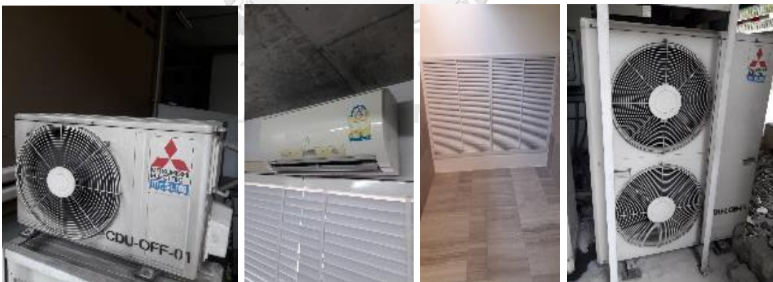
ภาพที่ 73 เครื่องปรับอากาศอาคาร D
