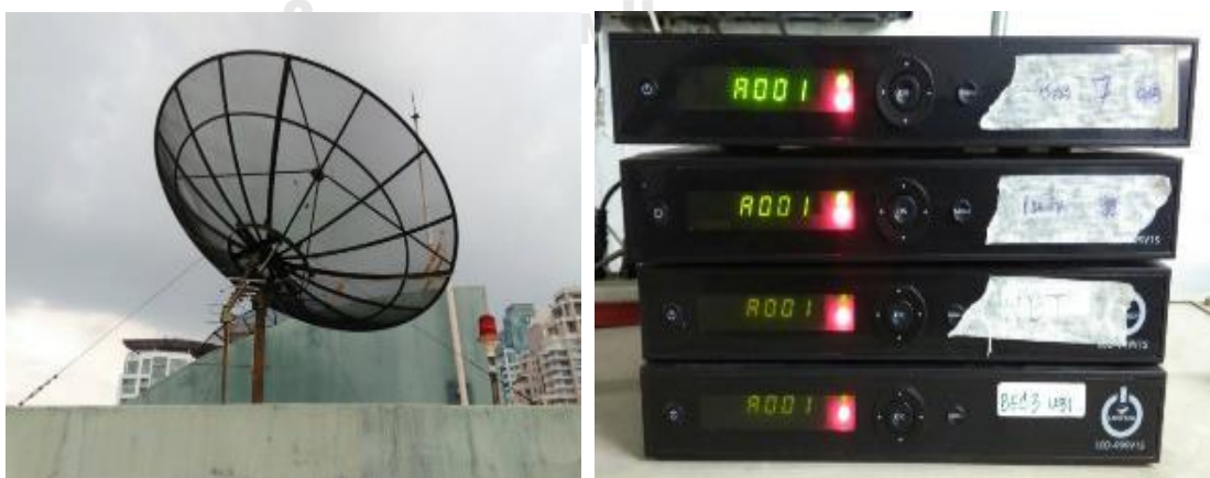
ภาพที่ 58 ระบบโทรทัศน์อาคาร C
