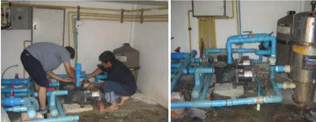
ภาพที่ 30 ห้องเครื่องระบบระเหยน้ำอาคาร B
