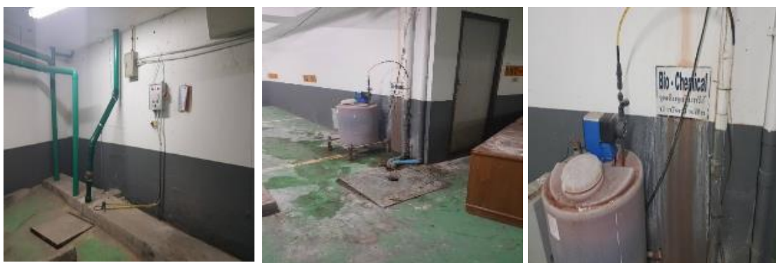
ภาพที่ 11 ระบบบำบัดน้ำเสียอาคาร A
