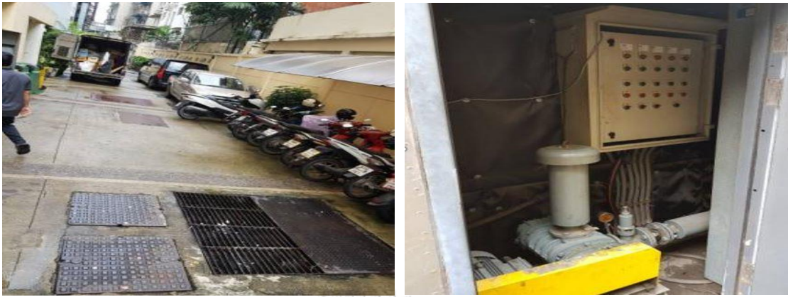
ภาพที่ 74 ระบบบำบัดน้ำเสียอาคาร D
