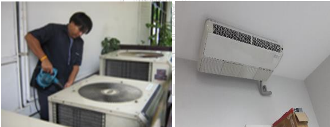
ภาพที่ 31 เครื่องปรับอากาศอาคาร B
