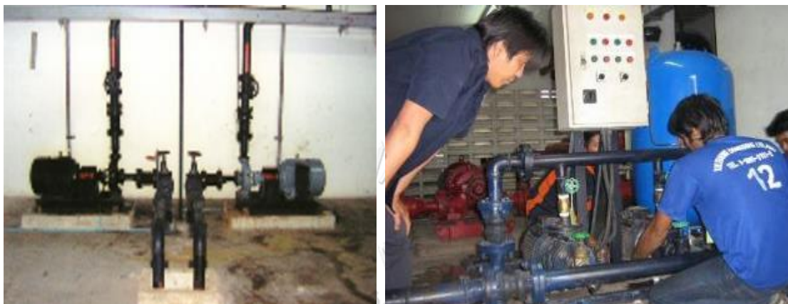
ภาพที่ 28 เครื่องสูบน้ำดี(ปั้มน้ำ)และ Booster Pumpอาคาร B
