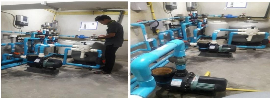
ภาพที่ 51 ห้องเครื่องสระว่ายน้ำอาคาร C
