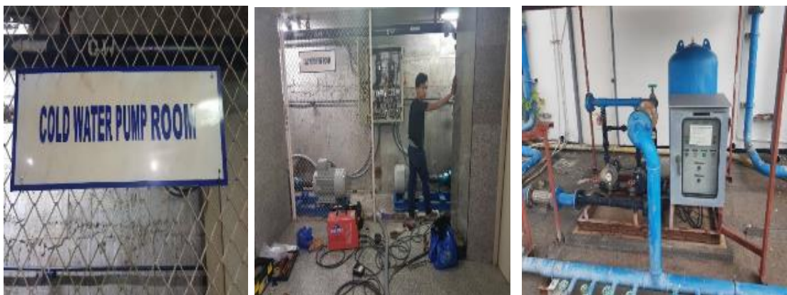
ภาพที่ 6 เครื่องสูบน้ำดี(ปั้มน้ำ)และBooster Pumpอาคาร A
