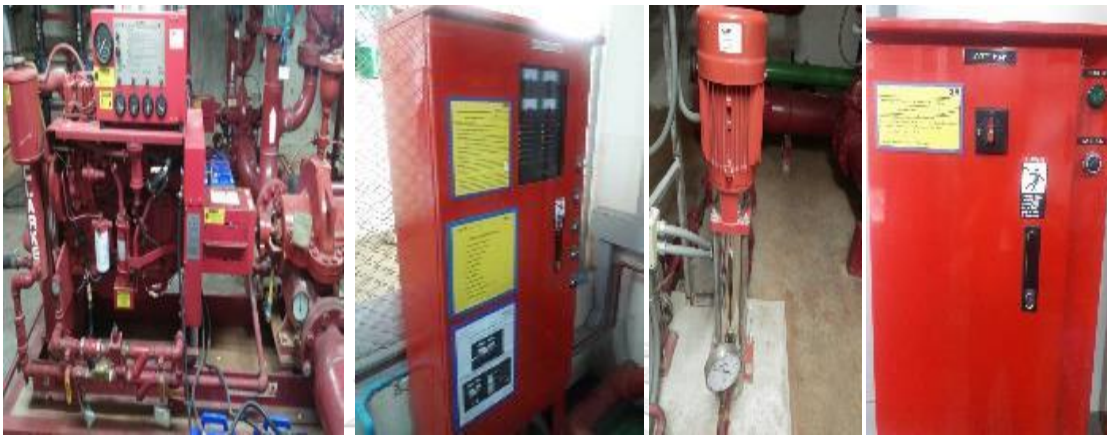
ภาพที่ 76 ระบบดับเพลิงอาคาร D
