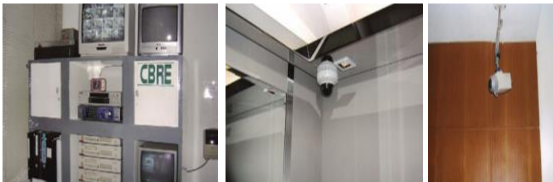
ภาพที่ 38 ระบบกล้องวงจรปิดอาคาร B
