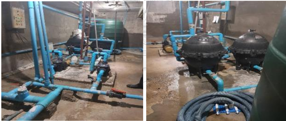
ภาพที่ 9 ระบบสระว่ายน้ำอาคาร A
