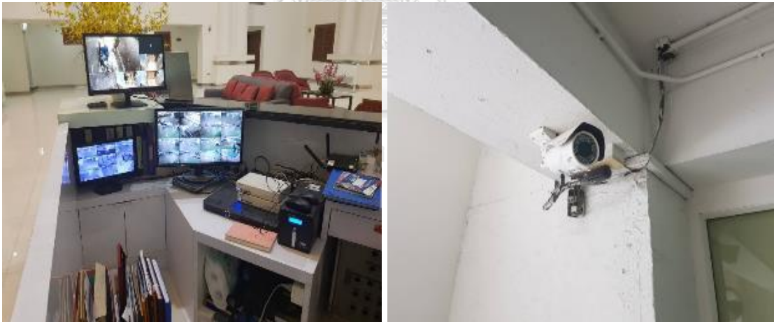
ภาพที่ 17 ระบบกล้องวงจรปิดอาคาร A
