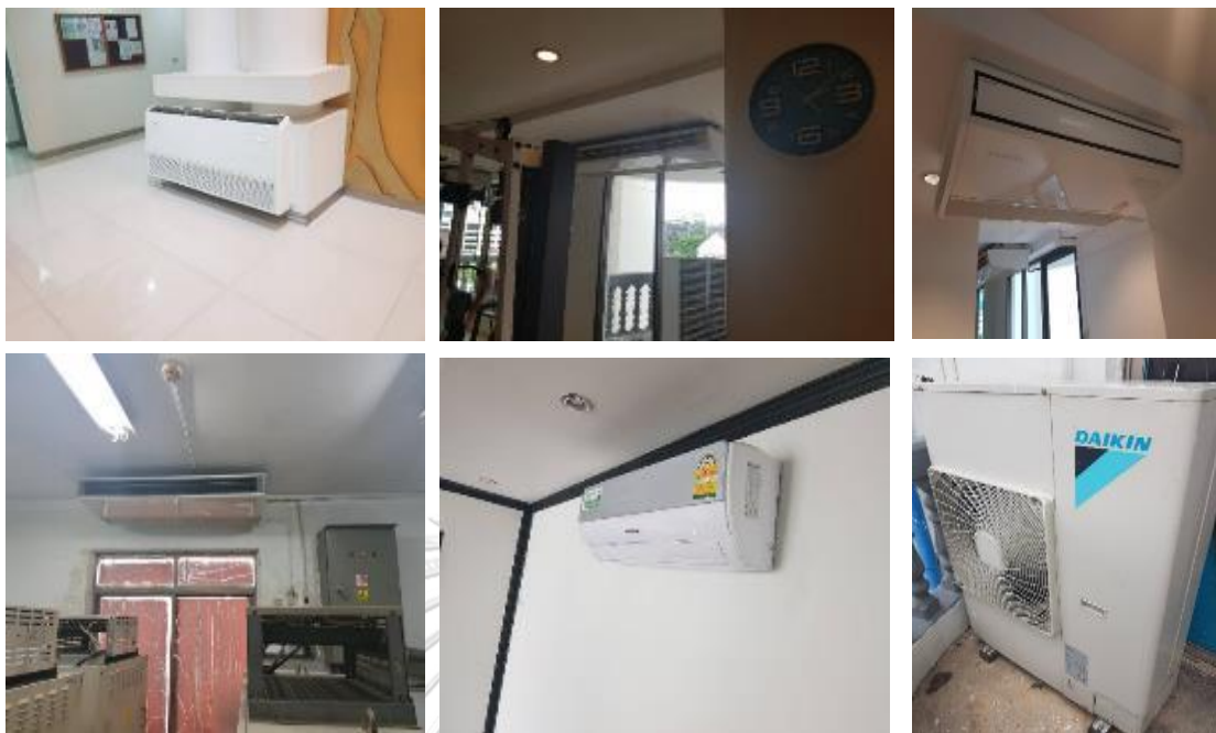
ภาพที่ 10 เครื่องปรับอากาศส่วนกลางอาคาร A
