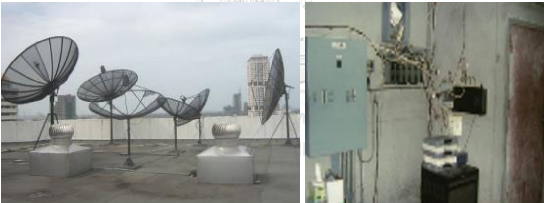
ภาพที่ 37 ระบบโทรทัศน์อาคาร B
