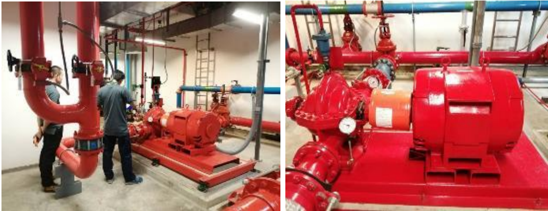
ภาพที่ 34 ระบบดับเพลิงอาคาร B
