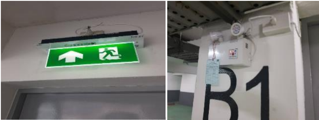
ภาพที่ 14 ป้ายทางหนีไฟและไฟส่องทางฉุกเฉินอาคาร A
