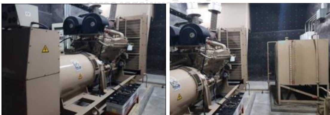
ภาพที่ 69 เครื่องกำเนิดไฟฟ้าสำรองอาคาร D
