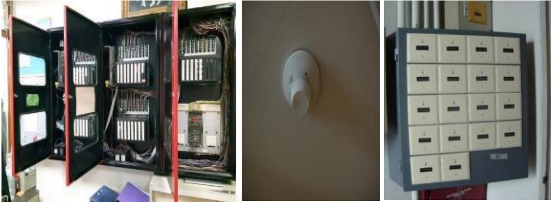
ภาพที่ 36 ตู้ควบคุมและอุปกรณ์แจ้งสัญญาณเหตุเพลิงไหม้อาคาร B
