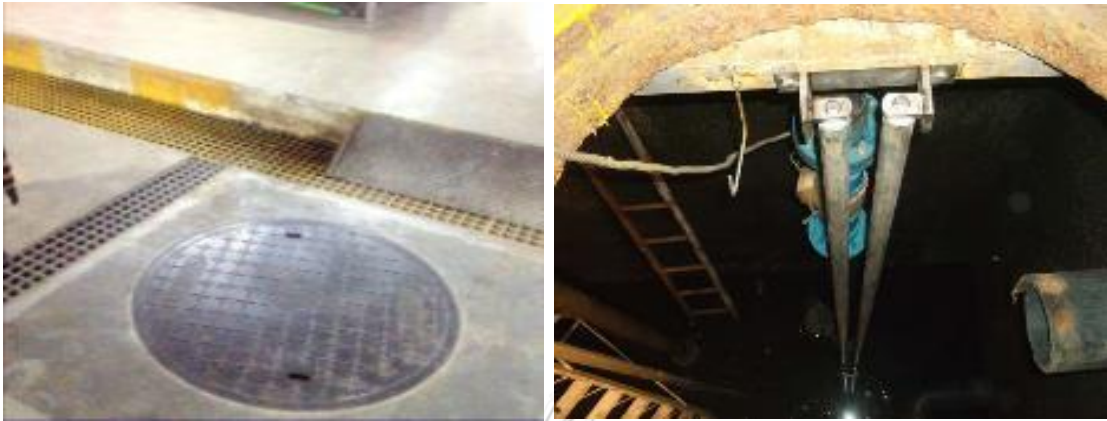
ภาพที่ 53 ระบบบำบัดน้ำเสียอาคาร C
