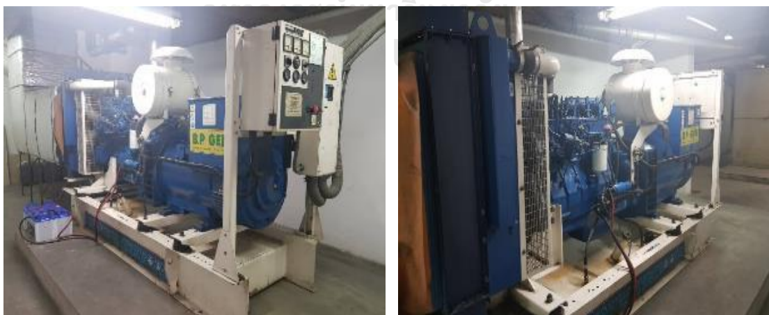
ภาพที่ 5 เครื่องกำเนิดไฟฟ้าสำรองอาคาร A
