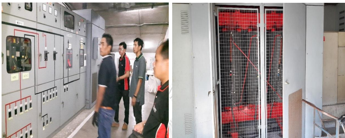
ภาพที่ 26 ระบบไฟฟ้าและหม้อแปลงไฟฟ้าอาคาร B
