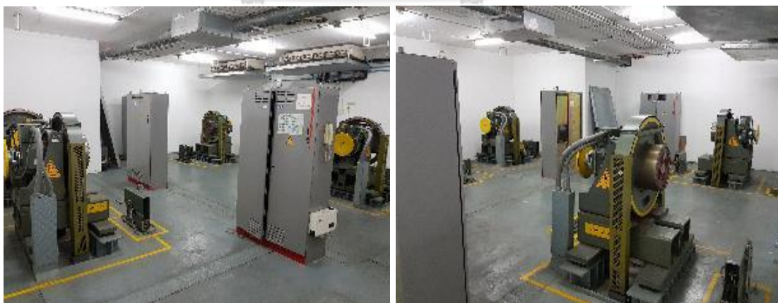
ภาพที่ 71 ระบบลิฟท์อาคาร D
