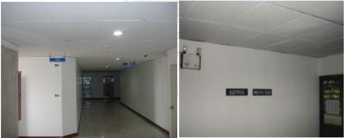
ภาพที่ 35 ป้ายทางหนีไฟและไฟส่องทางฉุกเฉินอาคาร B
