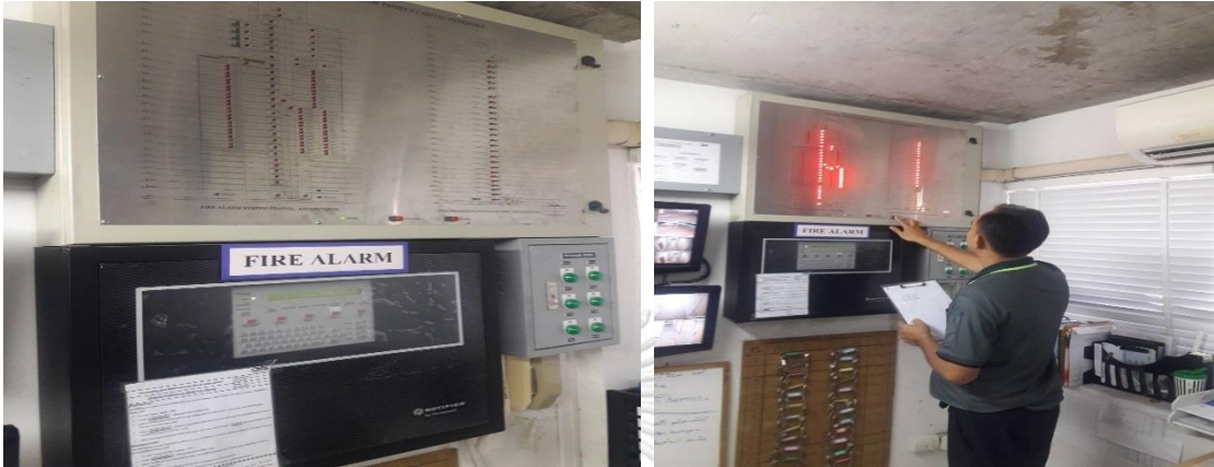
ภาพที่ 78 ตู้ควบคุมและอุปกรณ์แจ้งสัญญาณเหตุเพลิงไหม้อาคาร D
