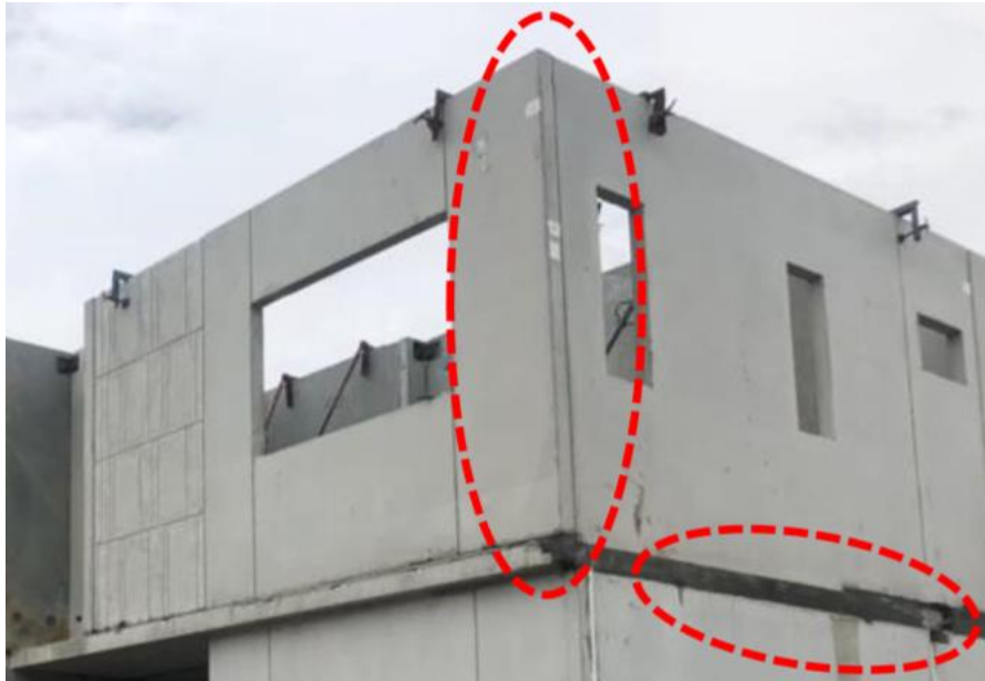
รูปที่ 77 การใช้ปูนซีเมนต์ไม่หดตัวบริเวณรอยต่อผนังภายนอก
