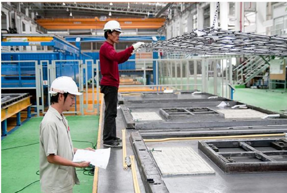
รูปที่ 75 การวางตะแกรงเหล็กเสริมในชั้นส่วนผนัง
