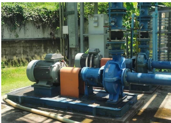
รูปที่ 26 ปั๊มน้ำ Cooling Tower A และ B
