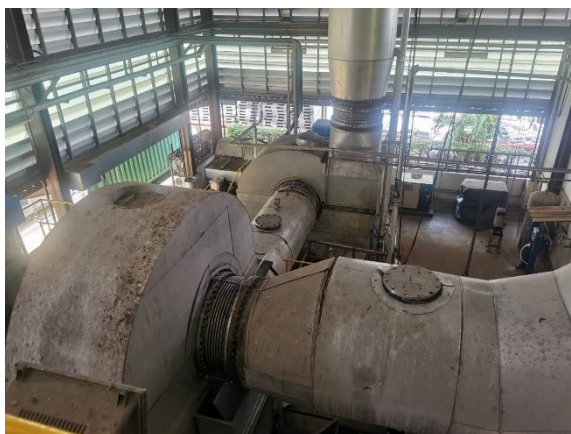
รูปที่ 25 พัดลม MVR 1 และ MVR 2
