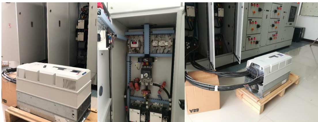
รูปที่ 24 รูปหลังดำเนินการปรับปรุง (หลังติดตั้ง VSD)
