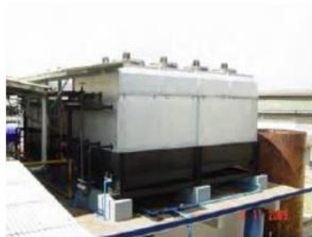
ข) ชุดระบายความร้อนเพื่อควบแน่น น้ำยานิยมใช้หอผึ่งน้ำที่ใช้น้ำกับอากาศ ระบายความร้อน ส่วนน้ำแข็งหลอด นิยมใช้ชุดระบายความร้อนแบบใช้น้ำ ระบายความร้อน
