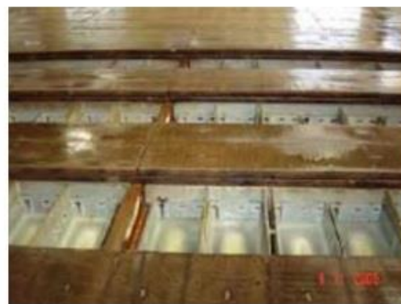
ง) บ่อน้ำเกลือและอุปกรณ์แลกเปลี่ยน ระหว่างแอมโมเนียและน้ำเกลือ
