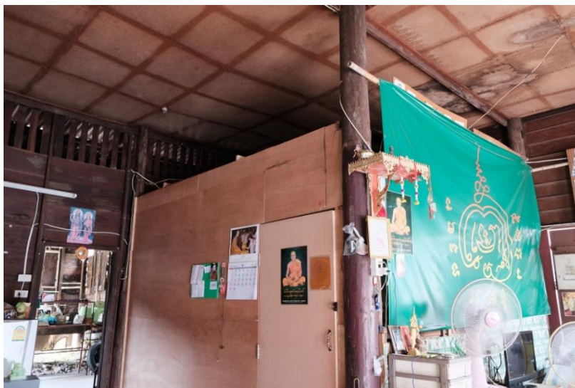
ภาพ 4-47 กั้นผนังใหม่ด้วยผนังโครงไม้เนื้อแข็งกรุไม้อัด
