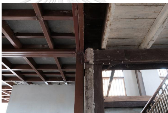
ภาพ 4-6 ภาพโครงสร้างเสาแกนเหล็กที่ต่อเติมแยกออกจากโครงสร้างเรียนเดิม
