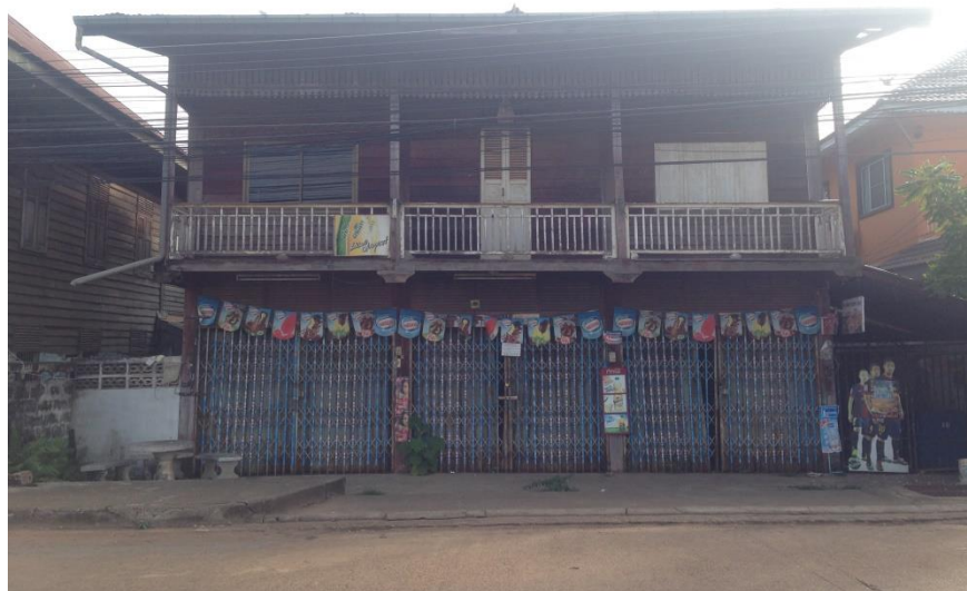
ภาพ 4-4 ภาพอาคารกรณีศึกษา A ก่อนการอนุรักษ์และฟื้นฟูครั้งล่าสุด ที่มา : ผู้วิจัย, 4 มกราคม 2560
