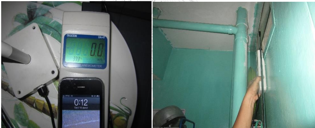
ภาพที่ 43 แสดงจุดวัดหาค่าอุณหภูมิ, ค่าความชื้นสัมพัทธ์และค่าความเร็วลมของพัดลมระบายอากาศ
