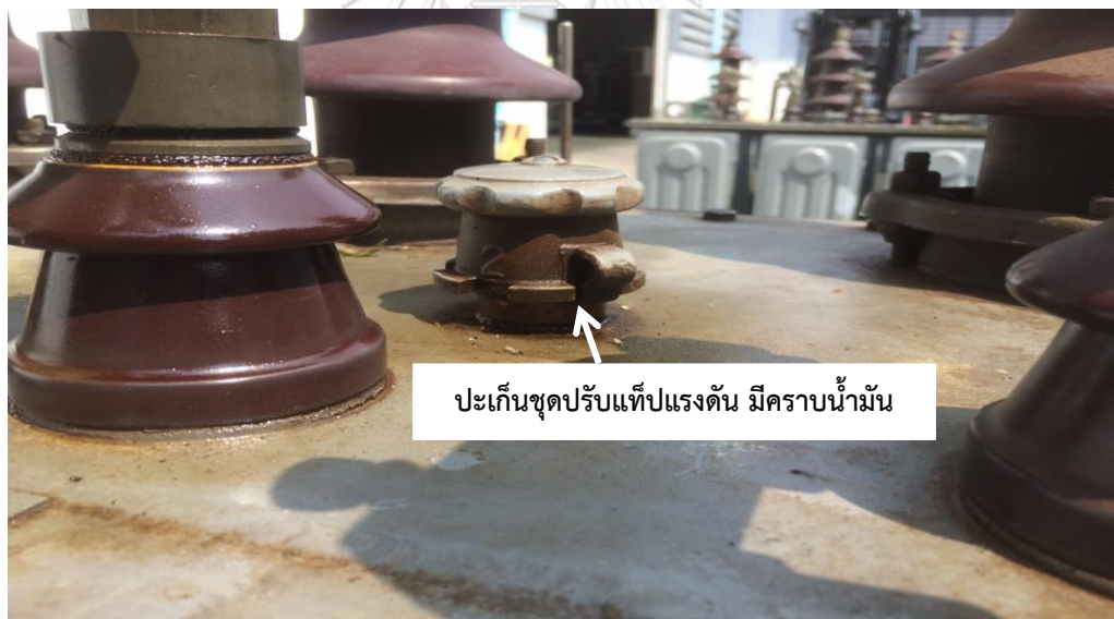
รูปที่ 15 ปะเก็นแท๊ปปรับแรงดันมีคราบน้ำมัน (ปะเก็นเสื่อมสภาพ)
