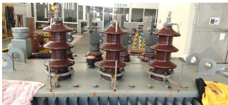
รูปที่ 13 ปะเก็นด้านแรงสูงและด้านแรงต่ำในสภาวะปกติ
