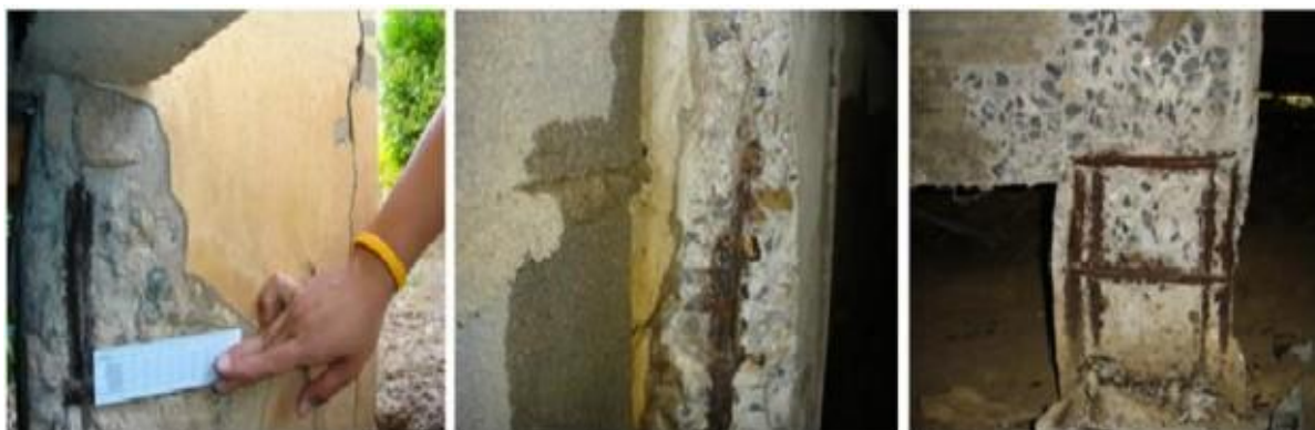
รูปที่ 1.3 การเสื่อมสภาพของเสาคอนกรีต (www3.rdi.ku.ac.th)
