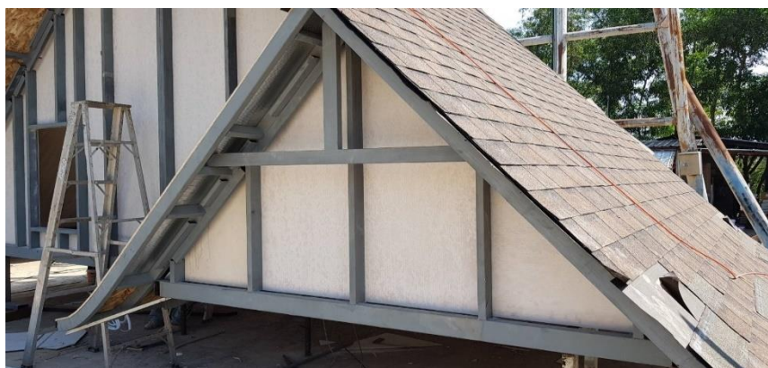
ภาพที่ 63 งานติดตั้งแผ่นหลังคา Shingle Roof
