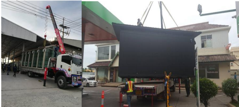
ภาพที่ 19 การขนส่งไปยังพื้นที่ก่อสร้างและการยกติดตั้งบ้านในพื้นที่ก่อสร้าง
