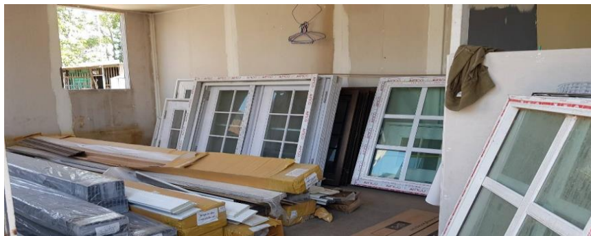
ภาพที่ 67 หน้าต่างสำเร็จรูปที่รอการติดตั้ง
