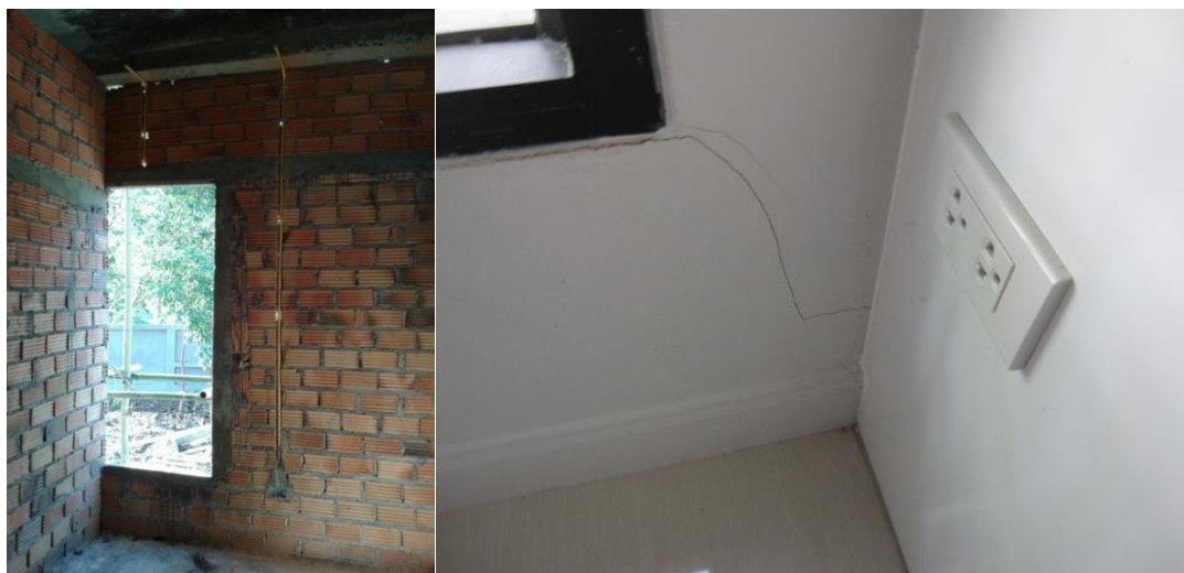
รูปที่ 1.1 ผงร้าวเกิดจากการก่อสร้างที่ไม่ได้มาตรฐาน
