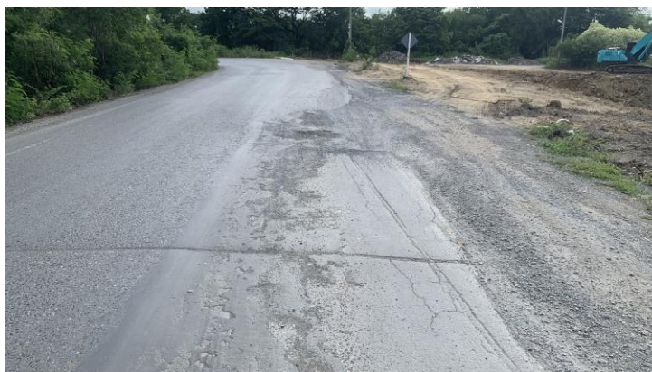
รูปที่ 2-5 ความเสียหายประเภทพื้นผิวถนนหลุดร่อน
