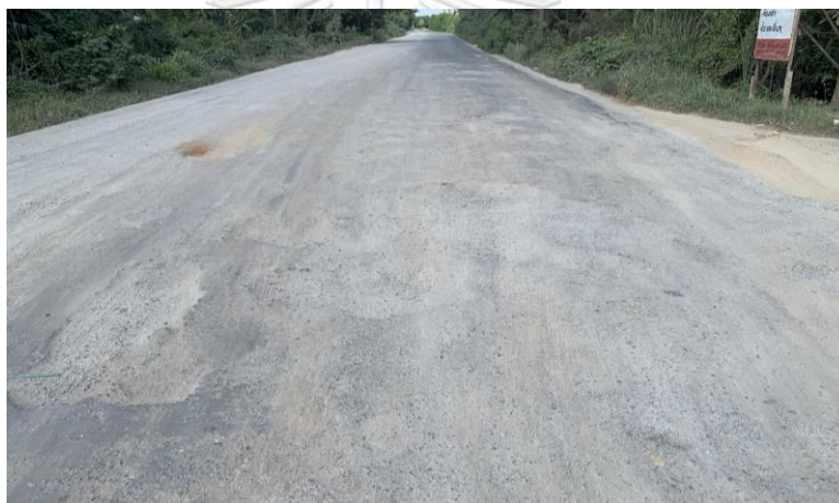
รูปที่ 5-2 แสดงบริเวณถนนชำรุดเสียหายอย่างหนัก
