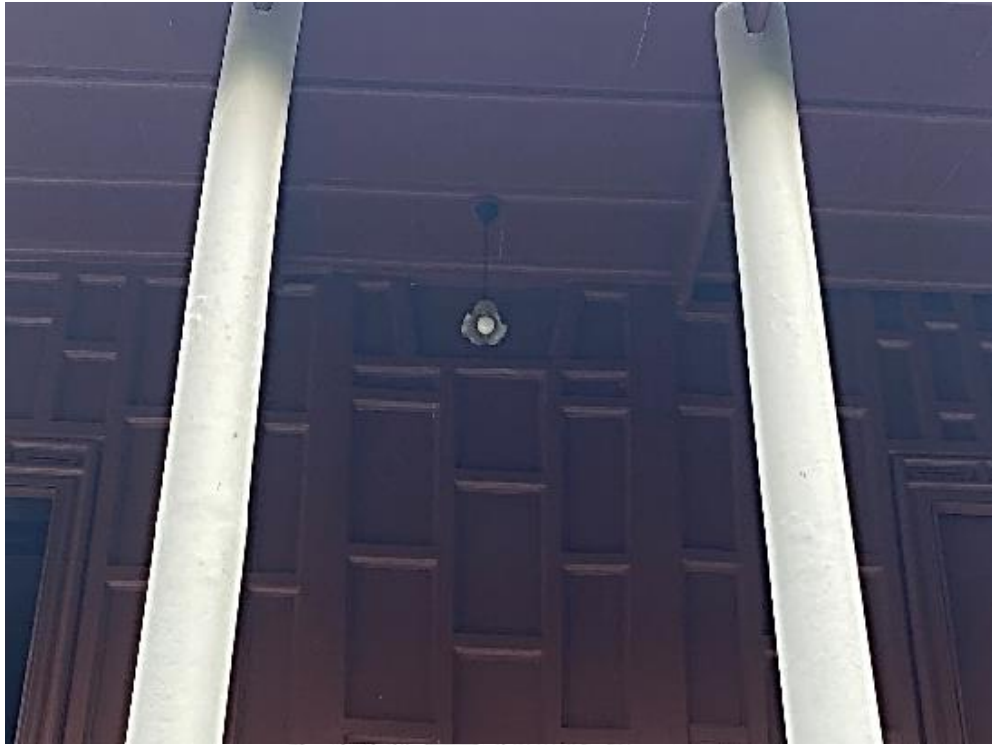
รูปที่ 64 ร่องรอยรางน้ำที่หลังคาอุยกยกขึ้นทั้งหมด (ที่มา: ผู้วิจัย, 2564)
