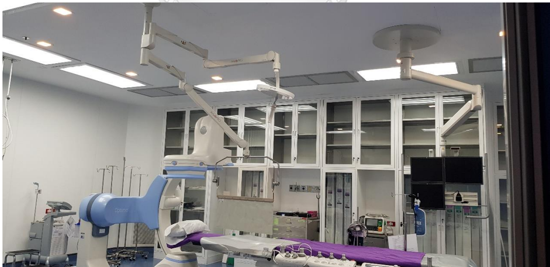
ภาพที่ 58 ภาพถ่ายห้อง Cath lab ชั้น 4
