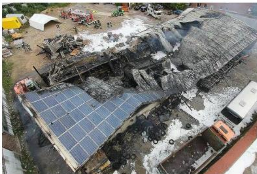
รูปที่ 16 ความเสียหายหลังจากเกิดเหตุเพลิงไหม้แผงผลิตไฟฟ้าด้วยพลังงานแสงอาทิตย์ของอาคารคลังสินค้า ในเมือง Noderney ประเทศเยอรมัน [33]
