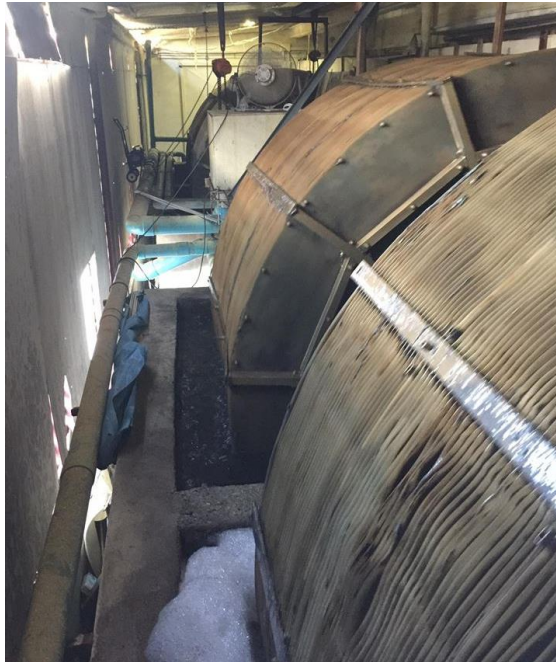
รูปที่ 24 จานหมุนชีวภาพของระบบบำบัด
