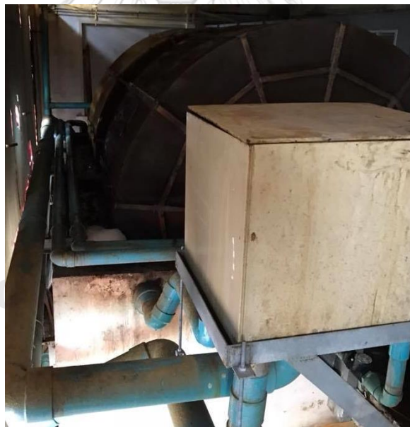
รูปที่ 25 บ่อรวมน้ำเสียของระบบบำบัด
