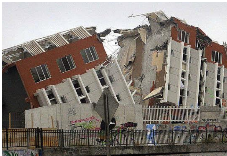
รูปที่ 1.2 การวิบัติแบบพลิกคว่ำของอาคารคอนกรีตเสริมเหล็ก
