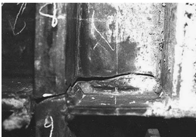
รูปที่ 1.6 การวิบัติของจุดต่อคานและเสาเนื่องจากรอยเชื่อมแตกหักที่เสา
