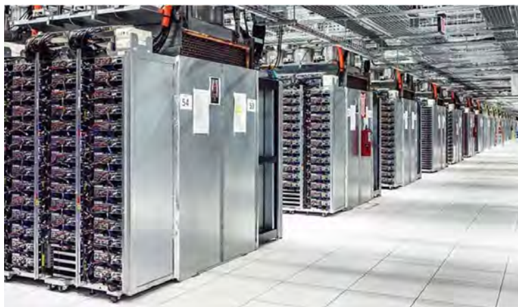
ภาพที่ 1: การออกแบบภายใน Data center
