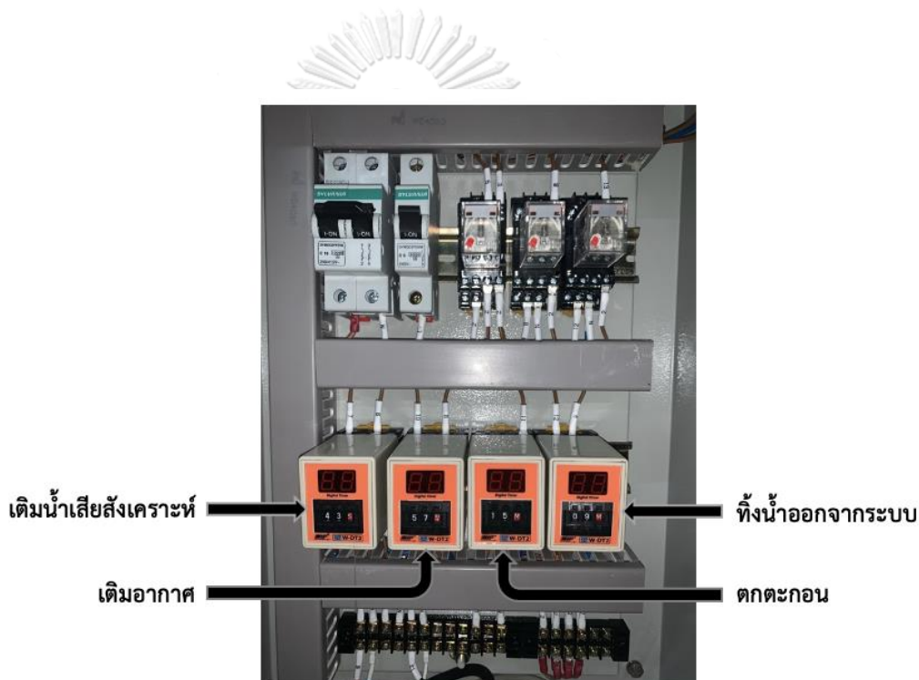
รูปที่ 3.2 ตู้ควบคุมไฟฟ้าและเวลาของระบบบำบัด
