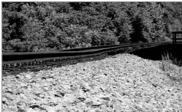
ภาพที่ 9 การทรุดตัวของบริเวณ Ballasted Track และ โครงสร้างสะพาน (National Academics of Sciences, 2006)
