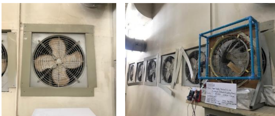
รูปที่ 4.22 พัดลมระบายอากาศที่ติดตั้งอยู่ในห้องหล่อชิ้นงาน (Casting Room) อาคาร SMT5 ชั้น 1
