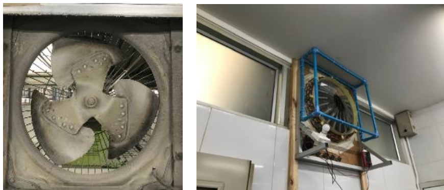
รูปที่ 4.23 พัดลมระบายอากาศที่ติดตั้งภายในห้องน้ำหน้าโรงอาหารอาคาร SMT5
