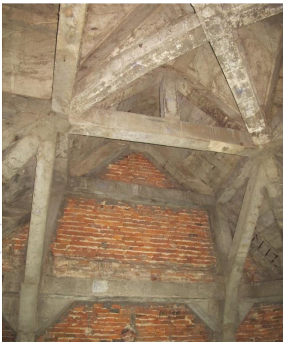
ภาพที่ 3.44 โครงสร้างหลังคา ค.ส.ล. พระมณฑป วัดพระเชตุพนฯ จากการบูรณะปรับเปลี่ยนโครงสร้าง ที่มา: ผู้วิจัย (2560)
