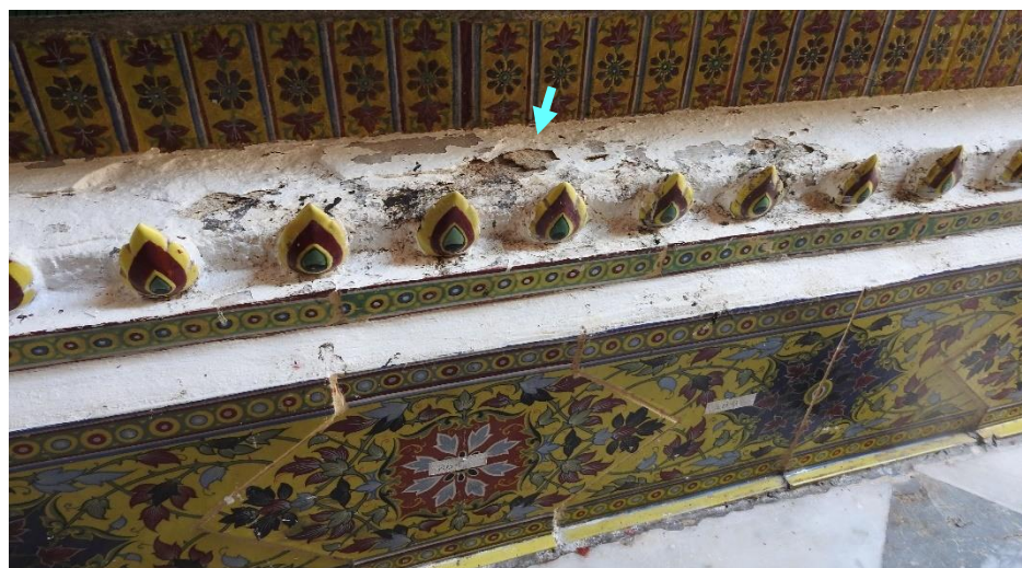
ภาพที่ 3.43 ความเสื่อมสภาพที่ผิวปูนฉาบ บริเวณฐานอาคารของพระวิหาร
