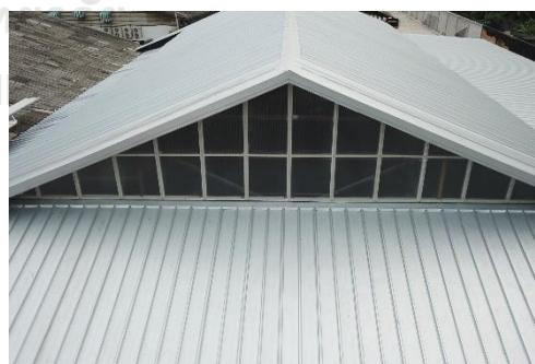
ภาพ 5.56 การติดตั้งหลังคาใหม่พร้อมช่องแสงธรรมชาติ
